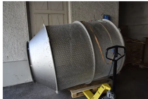
Dieses Sieb steckte bis vor kurzem als Endstück auf der Seewasserleitung.
