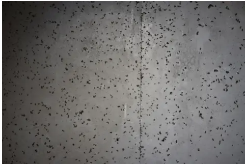
Blick durch ein kleines Fenster im Keller in die Seewasserleitung: Die schwarzen Flecken sind Quaggamuscheln.
